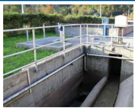
Trennbauwerk und Regenbecken
