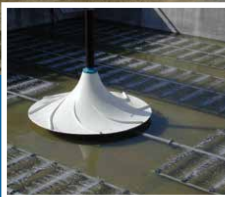
Belüfter und Vertikalrührwerk
